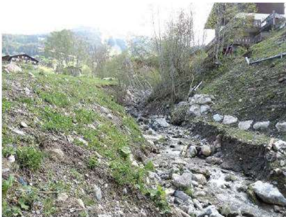
Zone amont affouillée en aval du pont de Béchigne
